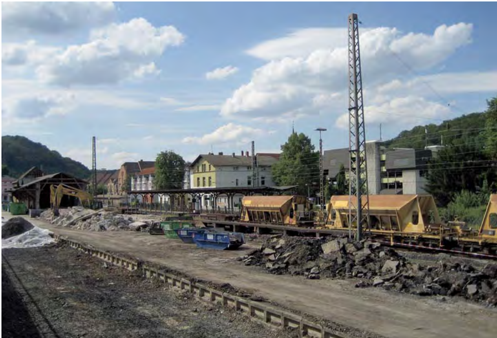
Abrissarbeiten am ehemaligen Güterbahnhof zur Vorbereitung des großen Brückenbauwerks Langenkamp- / Herrenstraße und Isenbergstraße Foto: Peter Mager, 21. Juli 2007
