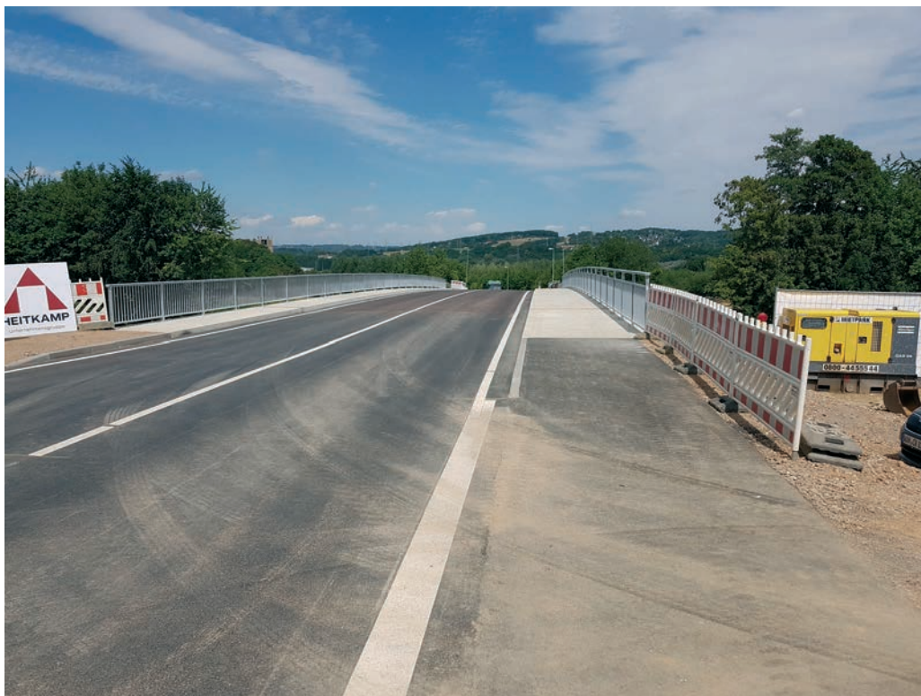
Die neue Brücke in der Hammacherstraße. Die Gesamtkosten belaufen sich für das Pilotprojekt „Baustein-Brücke“ auf 4,5 Mio. EUR und werden aus Bundesmitteln finanziert.
