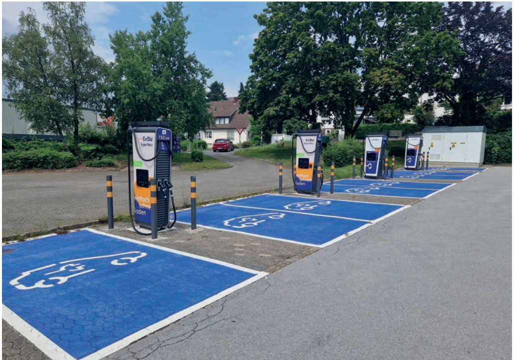
Neue 8 Schnellladestationen Parkfläche Einkaufszentrum Auf dem Lölfert
