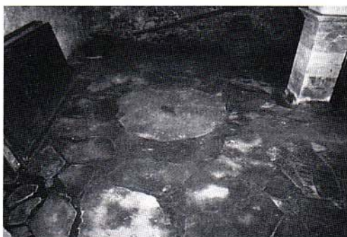
Auffälliger Belag im Boden des Kellers vom neuen Palas
