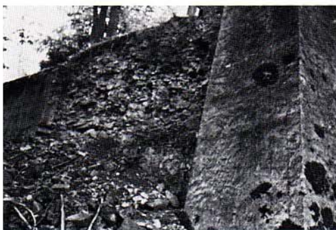
Kavernen hinter dem ausgebrochenen Blendmauerwerk an der nordöstlichen Gartenstützmauer Foto: U. Leifert, 24. 8. 1992
