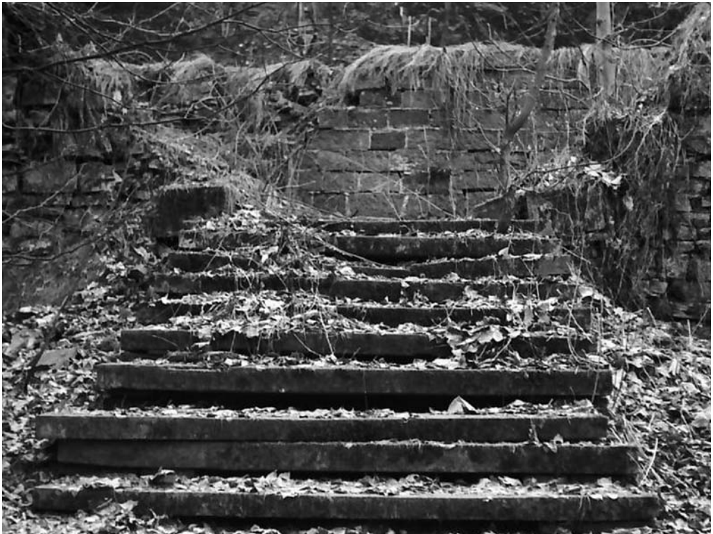
Die verfallene Treppe im ehemaligen Schloßgartenparterre, Februar 1980. Foto: Widbert Felka
