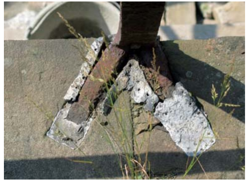
Situation am Fuß des Wehrgang-Geländers vor der Sanierung. Foto: Jochen Hüning, 17. Juni 2006
