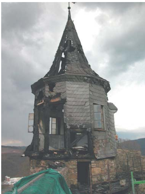
Der große Wehrturm am Tage des Blitzeinschlags. Foto: Julia Dettmann, 4. April 2006
